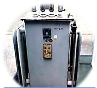
変圧器(トランス)
